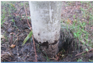
倒壊の原因となる腐食(錆)
